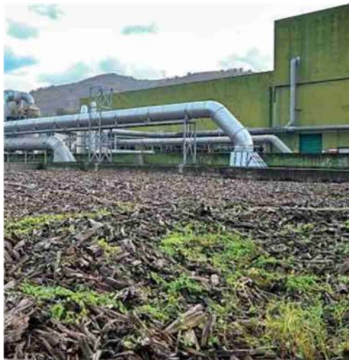
Un impianto di trattamento della frazione organica capace di generare un prodotto finito - il compost - che sarà utilizzato in agricoltura e florovivaismo
